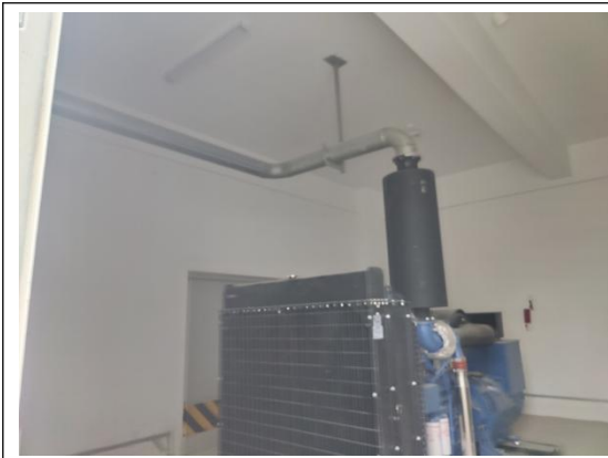
备用柴油发电机烟尘处理设施
